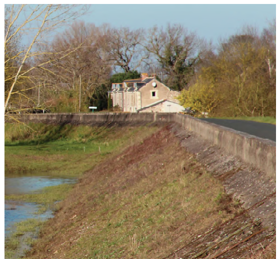
Tronçon de levée à la Maltête, sur la commune de la Possonnière.
